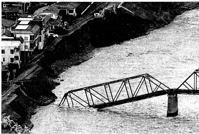
千曲川の増水で崩れ落ちた上田電鉄の鉄橋(14日、長野県上田市で、本社へリから)＝中村光一撮影
